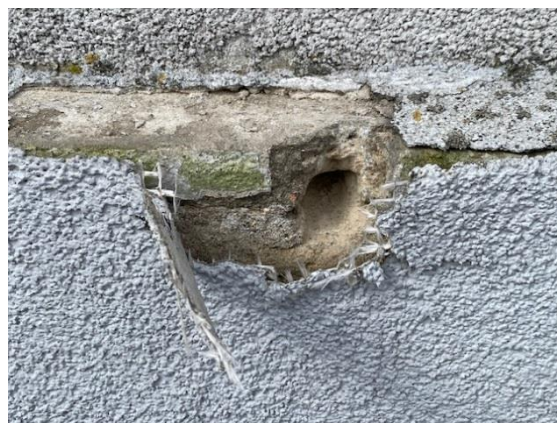
Widoczny wykwit mikroorganizmów pod siatką i tynkiem akrylowym.
